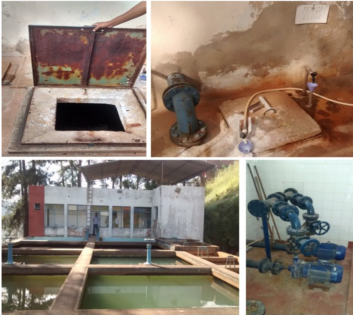
Imagem 5 - Estação de Tratamento de Água – ETA Principal (CISAB-RC 2016)
