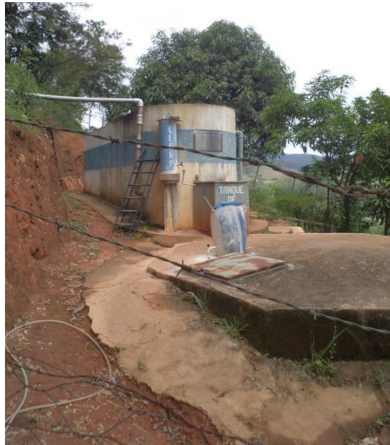
Imagem 8 - Mini-estação de Tratamento Pedra Furtada (PLAMSAB 2014)
