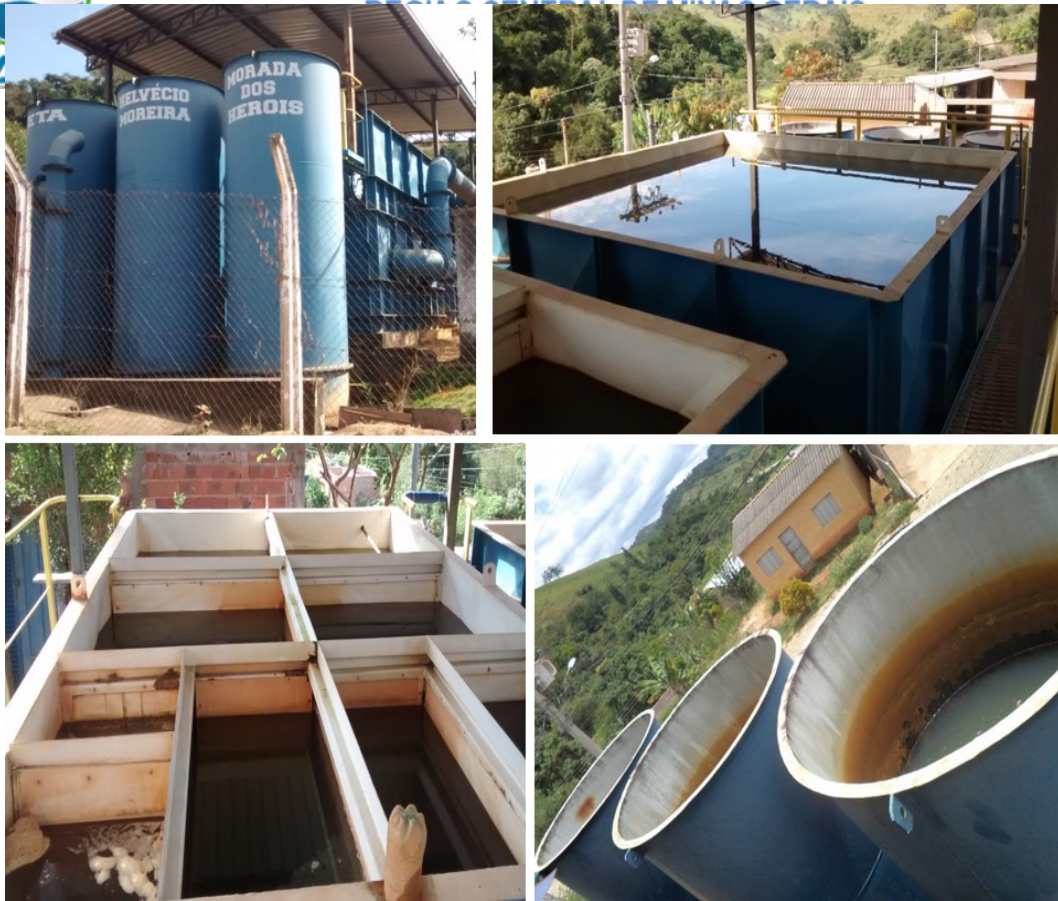
Imagem 6 - Estação de Tratamento de Água – ETA Morada dos Heróis (CISAB-RC 2016)
