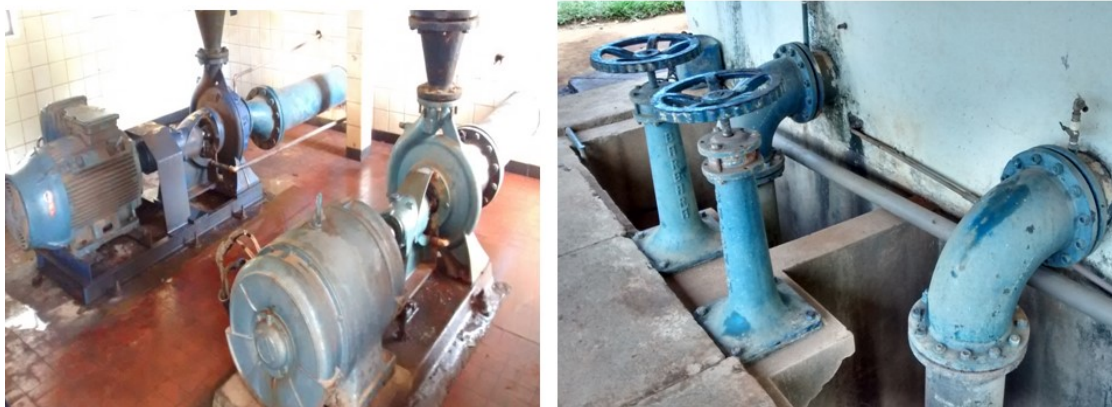
Imagem 4 - Estação Elevatória de Água Bruta (CISAB-RC 2016)
