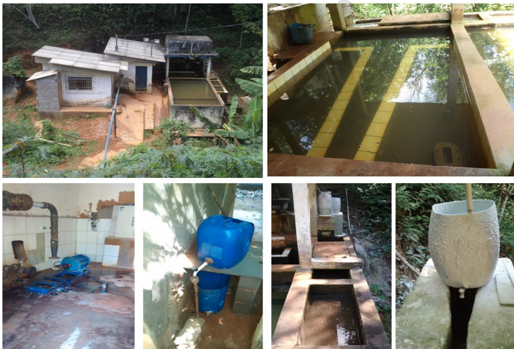
Imagem 7 - Mini-estação de Tratamento de Água Bairro Colina (CISAB-RC 2016)
