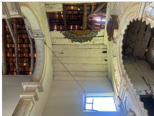
Figura 20: Detalhe do forro do altar mor com pintura artística e tábuas faltantes da Capela de Bom Jesus dos Perdões Autoria: Djair Junio de Souza Oliveira
