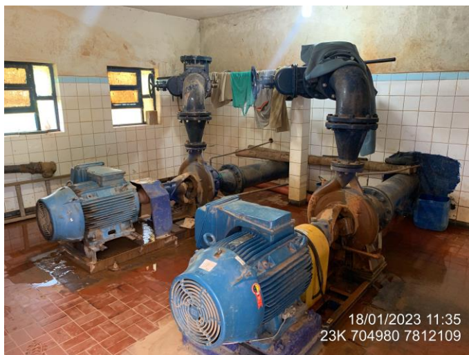
Figura 31 – Bombas para adução da água bruta
