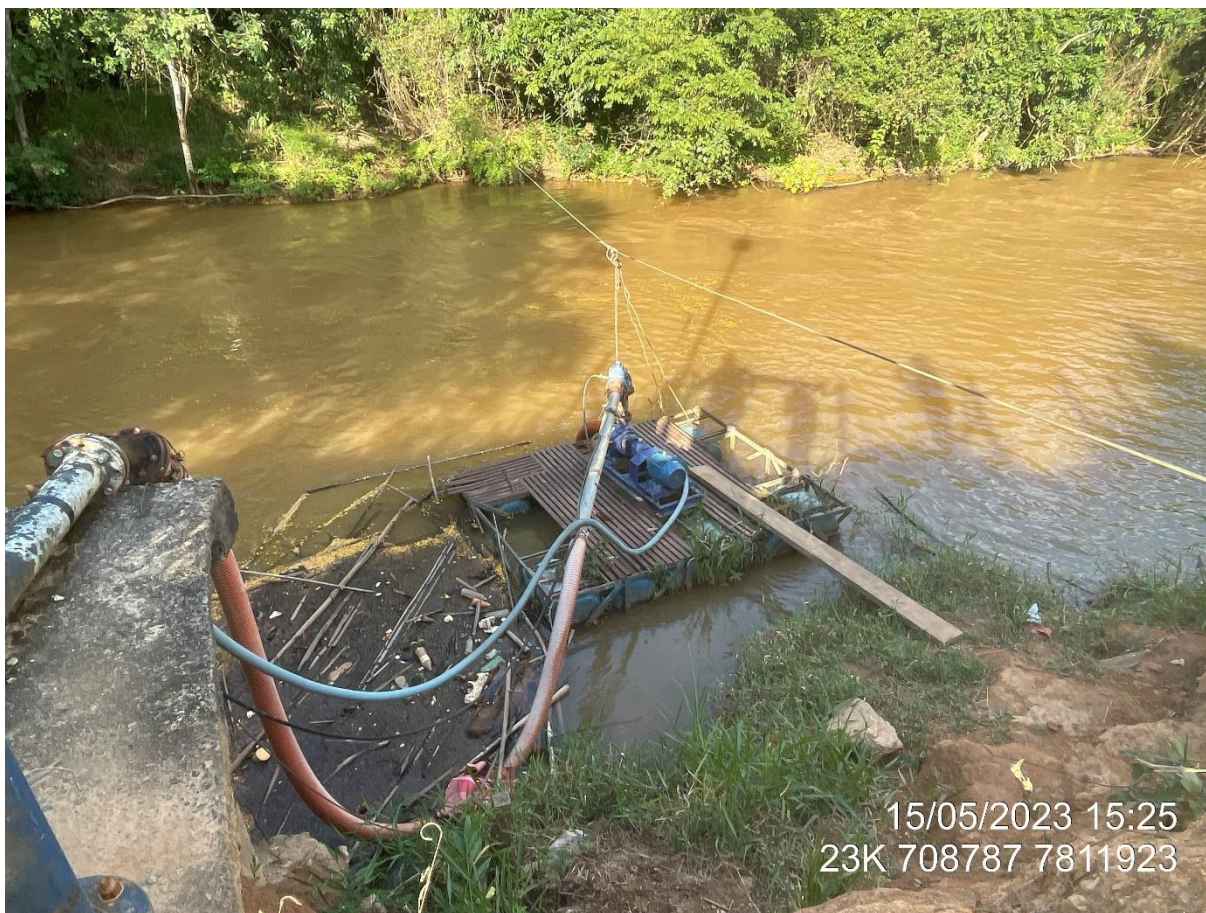
Figura 2 - Balsa para captação existente no Rio da Prata.
