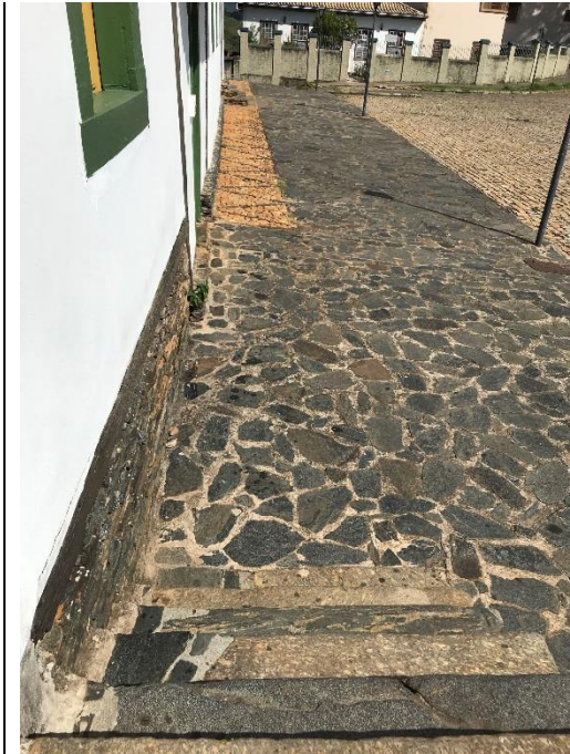
Foto 31: Vista parcial da pavimentação externa e alinhamento do imóvel junto ao logradouro público. A escada de acesso principal ao pavimento superior constitui elemento acumulador de águas e possibilita, assim, a infiltração de águas pluviais na base da edificação. Autoria: Daniel Quintão. Data: 23/05/2019.
