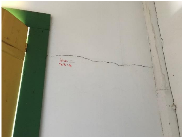
Foto 23: Pormenor da trinca horizontal, adjacente à janela e marcação do monitoramento realizado pela equipe da Prefeitura Municipal. Não houve evolução da trinca no período indicado, correspondendo ao momento em que foram instalados os pontaletes sob os barrote, nível do porão. Autoria: Daniel Quintão. Data: 23/05/2019.
