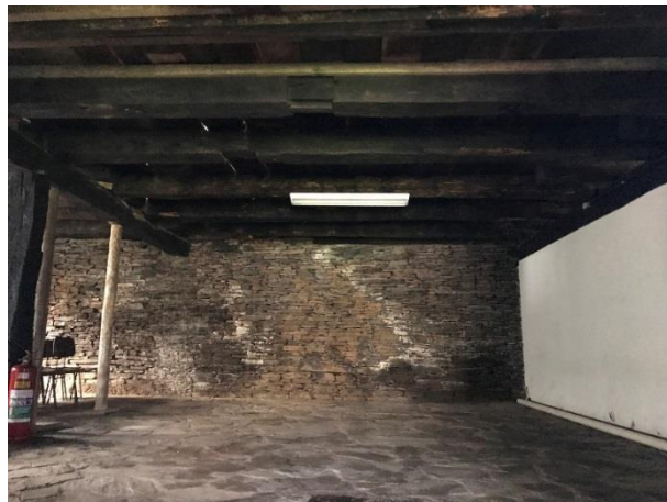
Foto 26: Vista interna do porão na região onde a madre adentra a parede de alvenaria de pedras de junta seca. Manchas sobre a alvenaria indicam sinais de infiltrações. Autoria: Daniel Quintão. Data: 23/05/2019.
