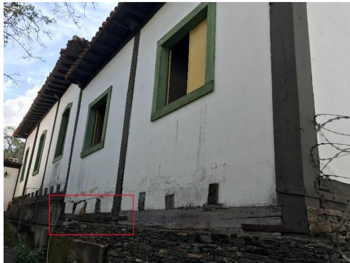
Foto 20: Vista parcial da fachada lateral direita e a localização do baldrame a ser substituído. Autoria: Daniel Quintão. Data: 23/05/2019.
