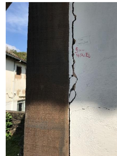
Foto 17: Vista parcial do encontro do esteio e parede. Pormenor da trinca na junção parede/ esteio. Autoria: Daniel Quintão. Data: 23/05/2019.
