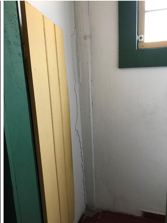
Foto 19: Vista interna da instalação sanitária e rachadura na parede causada pela movimentação do esteio. Destaque para o início da trinca a partir da junção do enxerto no esteio, onde não fora utilizado parafuso ou barras para travamento. Autoria: Daniel Quintão. Data: 23/05/2019.
