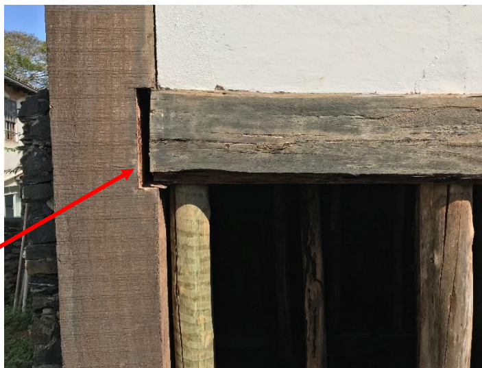
Foto 16: Vista parcial do encontro do esteio e madre. Pormenor do deslocamento da junção madre/ esteio. Autoria: Daniel Quintão. Data: 23/05/2019.
