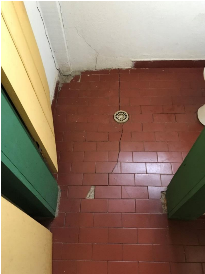
Foto 18: Vista interna do piso da instalação sanitária e rachadura na laje causada pela movimentação do esteio. Autoria: Daniel Quintão. Data: 23/05/2019.
