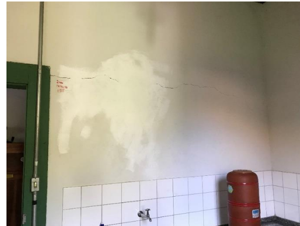
Foto 24: Pormenor da trinca horizontal, no mesmo cômodo. Não houve evolução da trinca no período indicado, correspondendo ao momento em que foram instalados os pontaletes sob os barrote, nível do porão. Autoria: Daniel Quintão. Data: 23/05/2019
