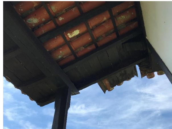
Foto 09: Pormenor do beiral na extremidade esquerda, onde não foi executado o frechal transversal. Todavia, não foram identificados movimentações, desaprumos ou outros danos decorrentes da ausência desta peça, uma vez que a solidariedade entre os frechais interno e externo se dá através dos caibros. Autoria: Daniel Quintão. Data: 23/05/2019
