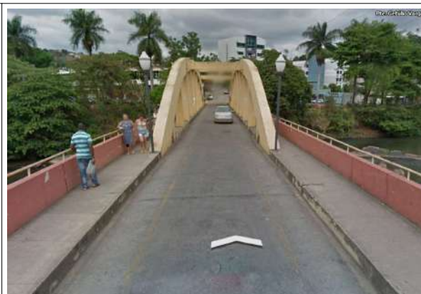
Figura 4 – Largura insuficiente para tráfego em dois sentidos.
